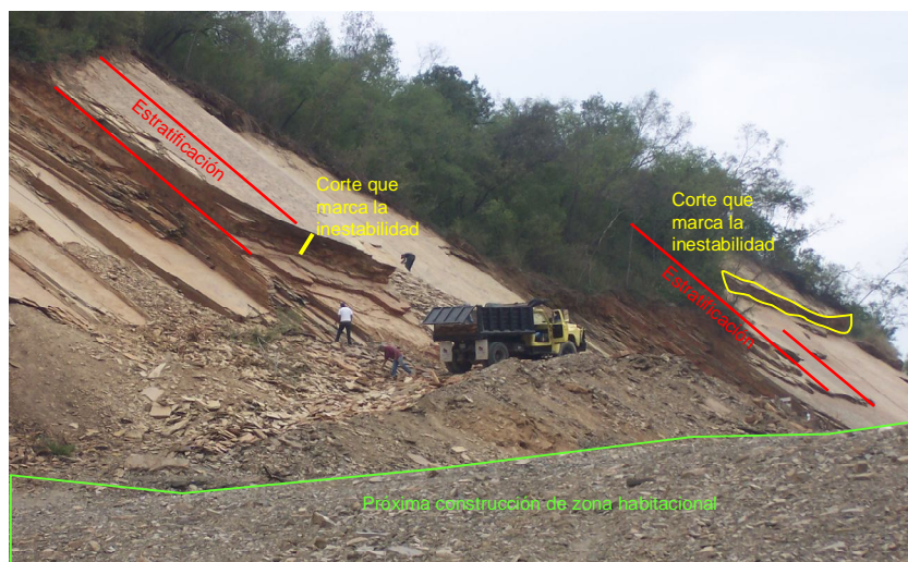
Fotografía 5. Inestabilidad de una ladera: tanto la inclinación de la ladera como la de la discontinuidad son paralelas; los cortes que se han efectuado aceleran el deslizamiento por falla planar de los estratos.
