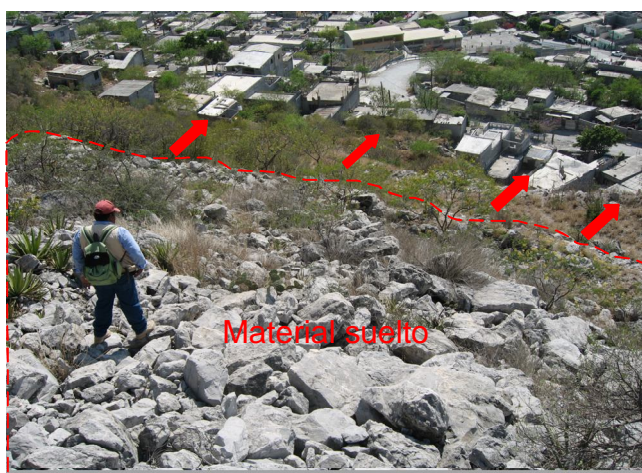
Fotografía 6. Indica el sentido de derrumbe de material suelto que se encuentra en una pendiente de 55%. (Amenaza a numerosas viviendas)
