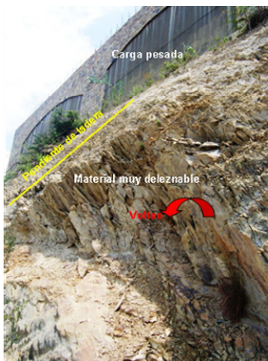
Fotografía 14. Áreas en alto riesgo dada la presencia de material muy intemperizable
