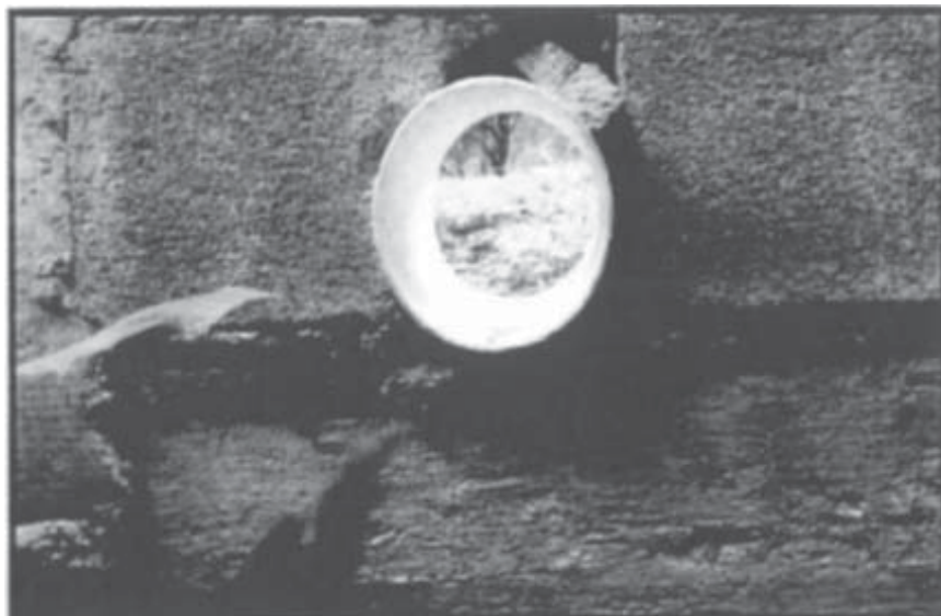
Figura 9. Imagen de un tubo colocado a manera de dren en la barda perimetral del predio vecino con el fin de permitir el desalojo del agua hacia el predio en estudio.
