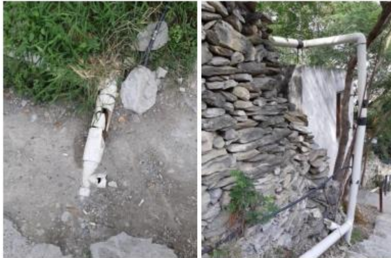
Figura 45. Vistas de tubería de drenaje sanitario expuesto en andadores peatonales
