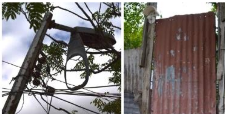
Figura 43. Estado típico de alumbrado en andadores Informales. Cerro La Campana.
