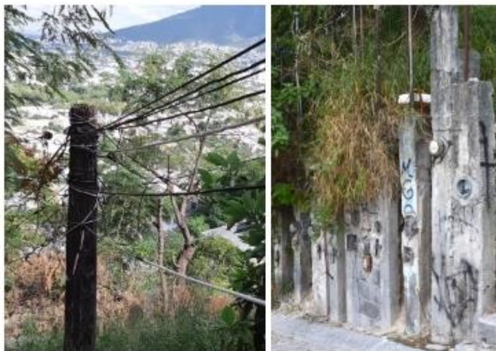
Figura 46. Vistas de instalación eléctrica en la zona
