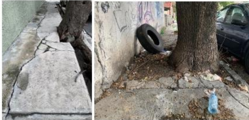
Figura 31. Ejemplos de banquetas en mal estado dentro del Distrito
