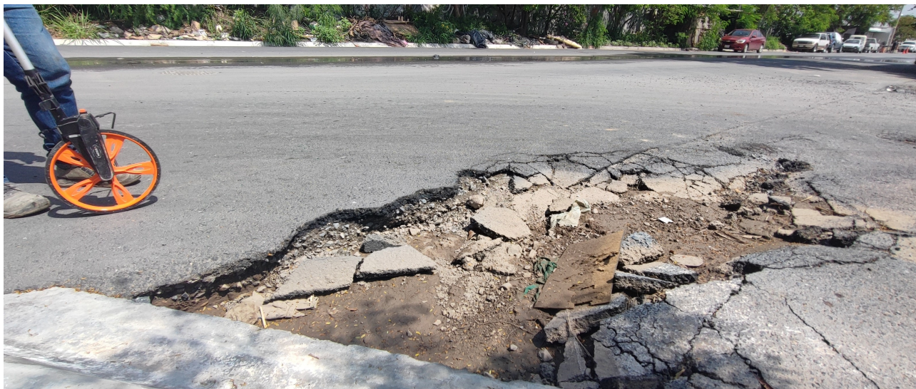
Deterioro único, socavación en estructura del pavimento, en cadenamiento 0+754 de la calle Vaqueros.
